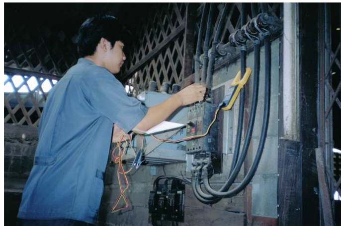
รูปที่ 2 แสดงการตรวจวัด Main Breaker หม้อแปลงขนาด 1000kVA
